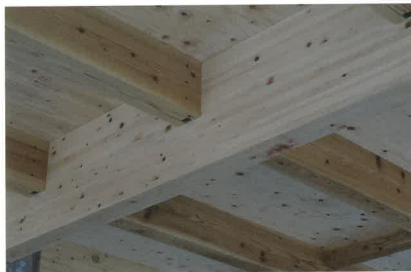
大梁・小梁には桧集成材と岐阜県産杉無垢材（梁せい240mm）
